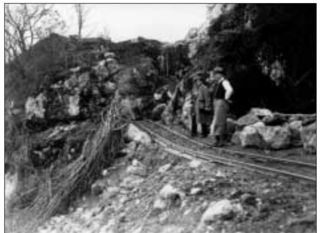
Rochennes: Besichtigung der Schäden
